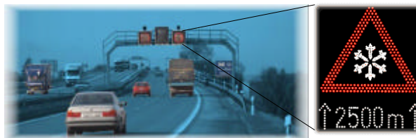
Abb.3 VMS – Variable Message Signs entlang von Autobahnen
